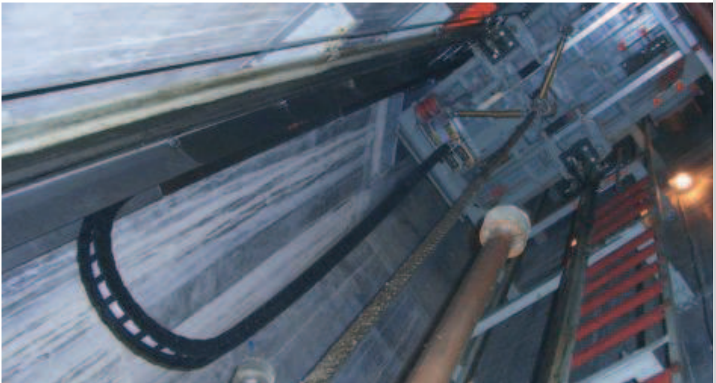
E2/000 - Stabilität der Energiezuführung auch bei ständigen Luftzug und die dadurch resultierenden Pendelbewegungen in diesem 160 m hohen Aufzug des Post Towers, Bonn
